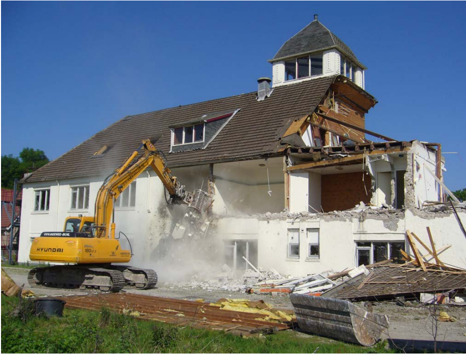
Figuur 17. De sloop van een monumentaal pand vraagt om een voorlopige voorziening
